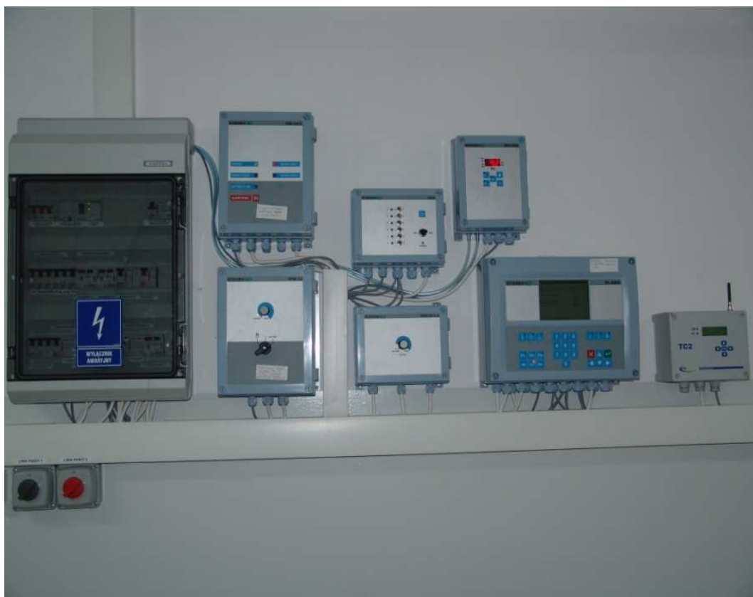
Fot. 8. Komputerowy sterownik mikroklimatu pomieszczeń Photo 8. Computer controlled indoor climate system
