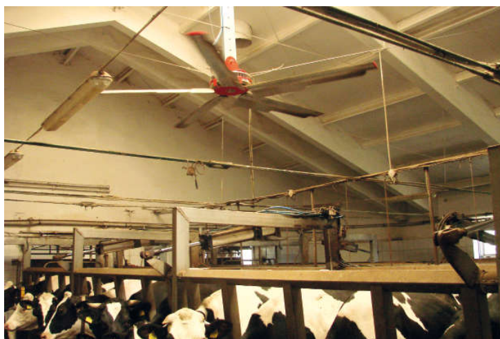
Fot. 3. Wentylator sufitowy w hali udojowej Phot. 3. Ceiling fan in milking parlour
