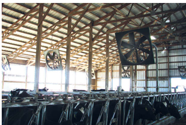
Fot. 1. Wentylatory osiowe nad korytarzem karmowo-gnojowym i boksami legowiskowymi w oborze wolnostanowiskowej
